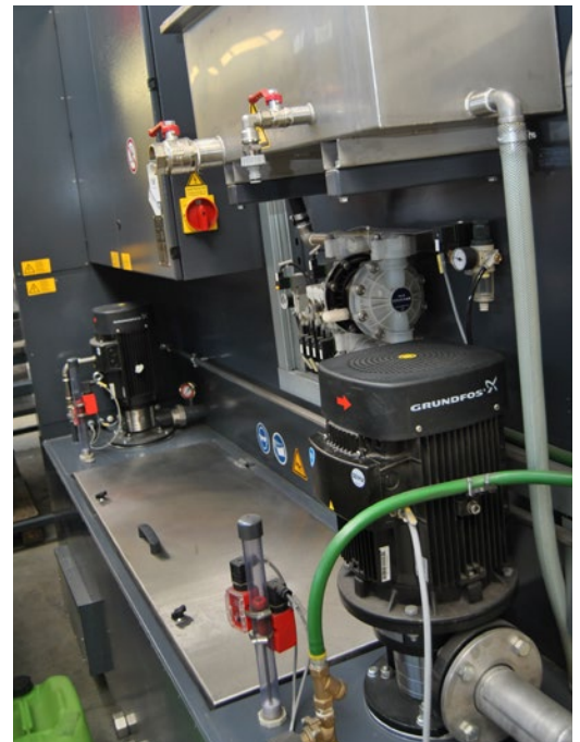
Die besonders energieeffizienten Grundfos-Pumpen sind ebenso wie das Reinigungs- und Spülbad und der Ölabscheider leicht zugänglich außen an der Anlage angebracht.
