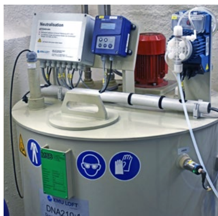
Die Anlage ist mit allen Tanks und Nebenaggregaten in einem nur 5,3 x 3,6 m kleinen Kellerraum installiert.
