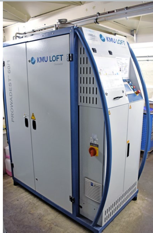
Die Reinigung des Spülwassers erfolgt in einem über die MAP PAMMINGER GMBH bezogenen Vakuumverdampfer PROWADDEST P60/1 der KMU LOFT Cleanwater GmbH.
