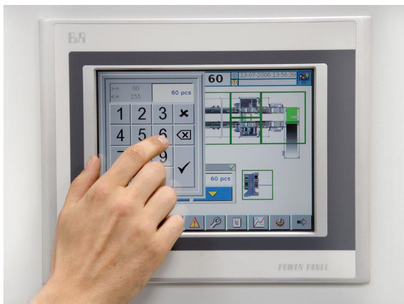
Anlagensteuerung mit moderner, einfach bedienbarer Oberfläche
