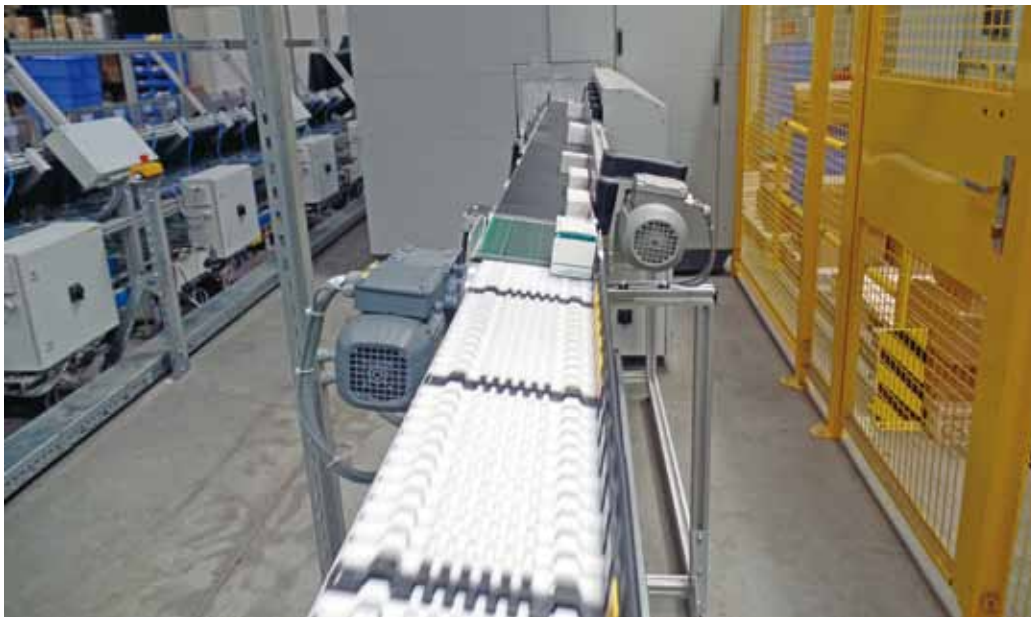
Der 33 m lange Gliederketten-Förderer ist an beiden Enden angetrieben. Die Übergabe an das integrierte Band des Scanner-Tunnels erledigt ein Messerkanten-Riemenband.
