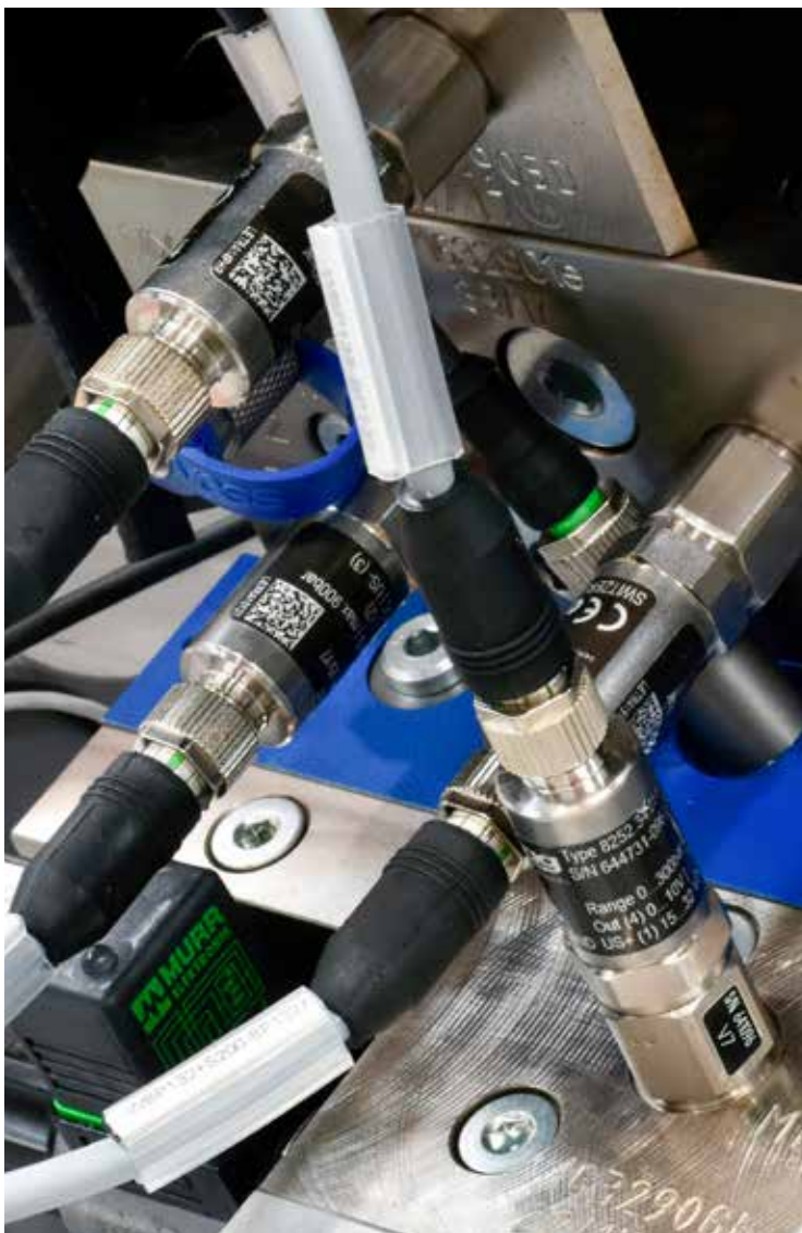
An jedem Abgang der Hydraulikblöcke überwacht ein Industrie-Drucktransmitter NAT 8252 von Trafag mit Dünnschicht-Stahlmembran den Hydraulikdruck . Ein vorgeschaltetes Stoppventil V7 desselben Herstellers ermöglicht den Austausch des Transmitters unter Druck.
