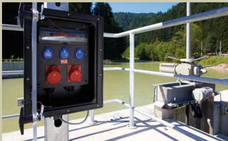
Saubere Energie aus erneuerbaren Quellen mit sauberer Steuerungs-Elektrotechnik.
